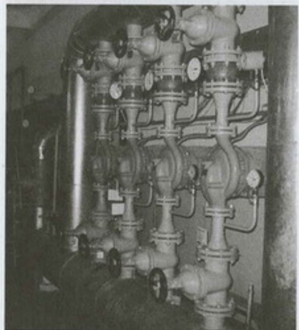
Экономичные сетевые насосы котельной конструкции «инлайн», по 11 кВт каждый, не требуют обслуживания и не имеют опор или фундаментов
